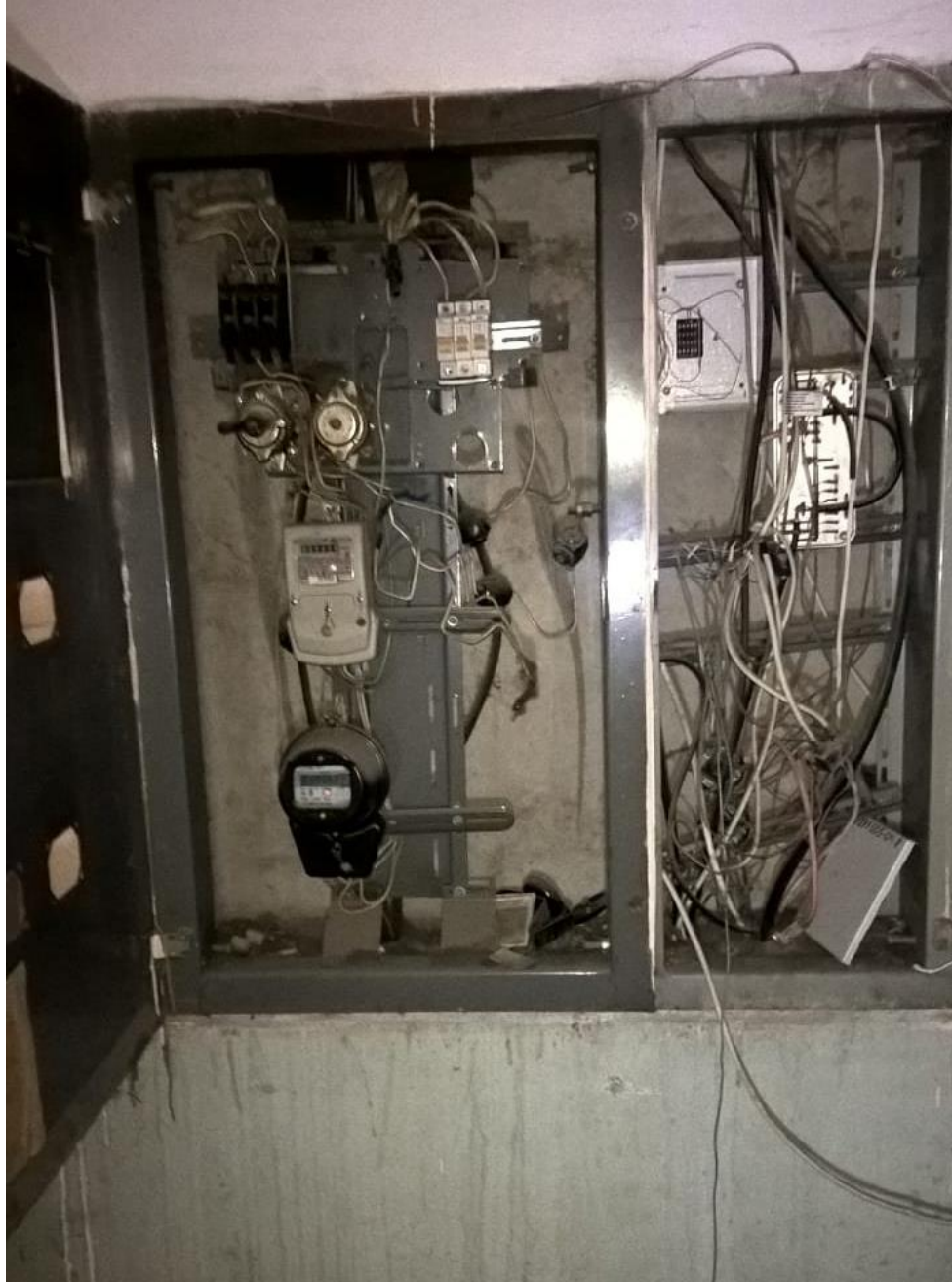
Фото 7. Неудовлетворительное состояние этажных щитков
