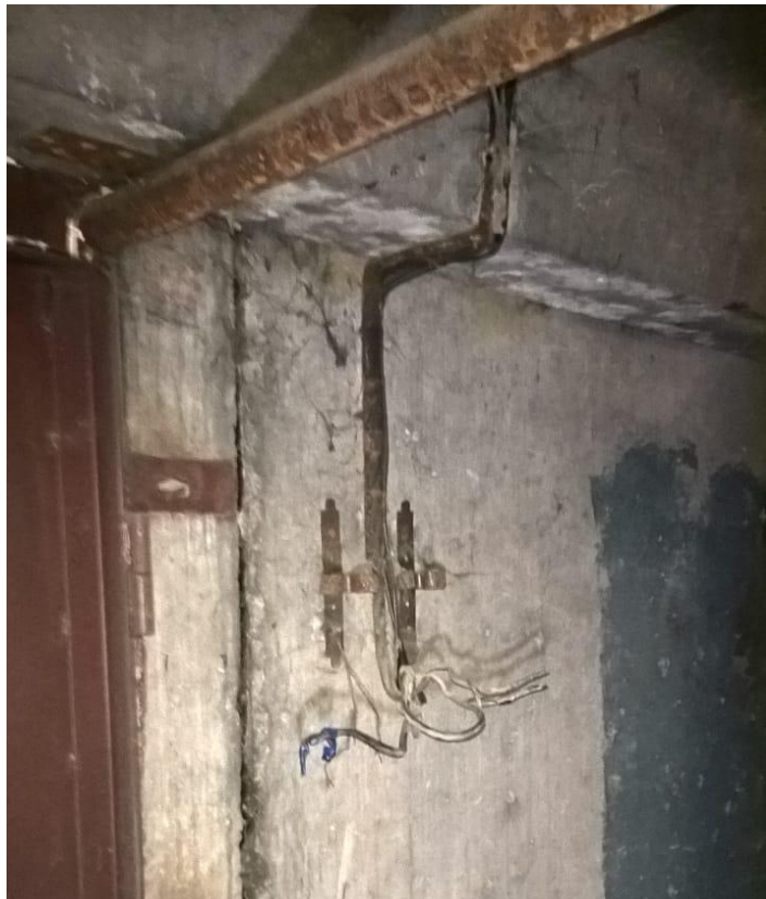
Фото 5,6. Электропроводка освещения в подвале
